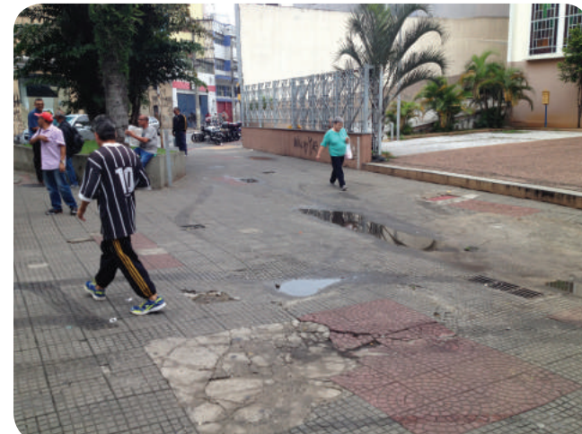
Foto 4: Avenida Conde Francisco Matarazzo, condições insuficientes de drenagem e conservação, na Área Central. Fonte: Do autor
